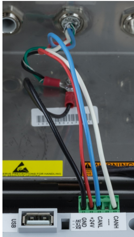
Figure 2-60 : Câbles POWERCELL connectés au terminal
