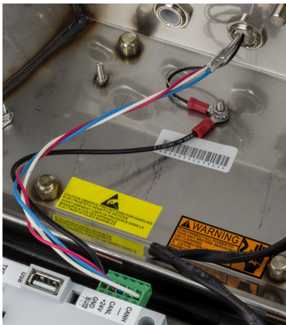
Figura 2-79: Armadietto per ambienti difficili PowerMount, cablaggio completato
