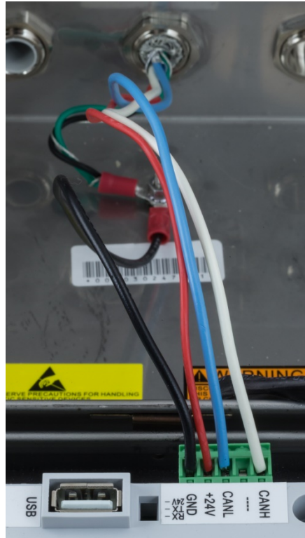
Abbildung 2-58: Im Terminal angeschlossene POWERCELL-Adern
